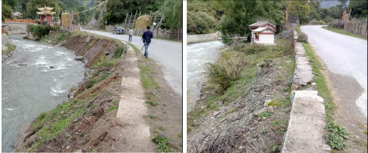
沿河冲刷地段路肩墙破损现状
