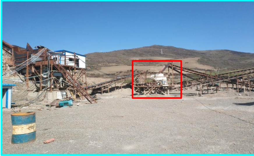
圆锥破碎机（新址工业场地）
