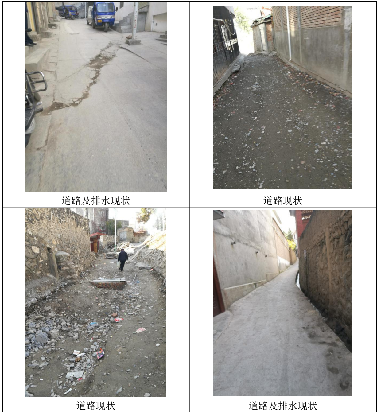
图 1 舟曲县城关镇城郊片区道路及排水现状
