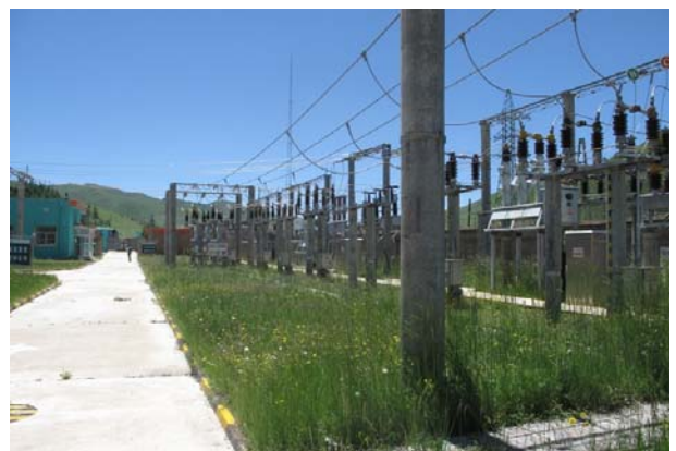
站区西侧 35kV 设备区
