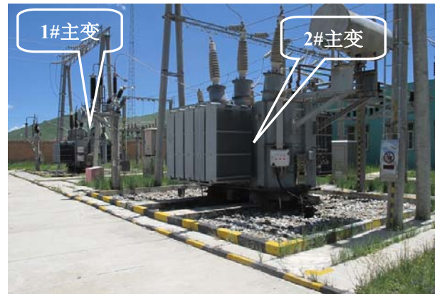
站区中央 2#主变位置
