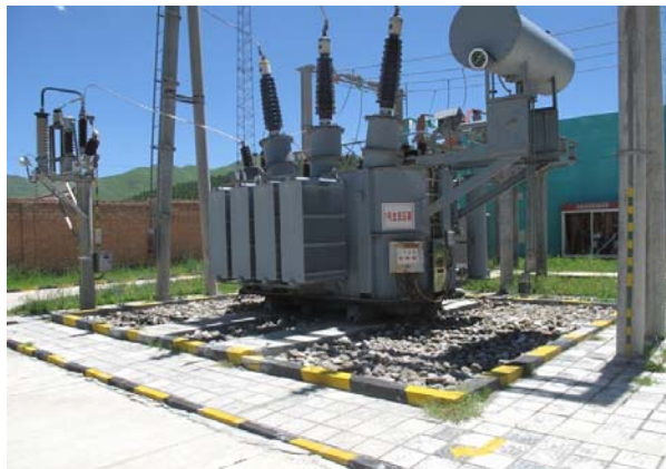
本期增容改造 1#主变位置
