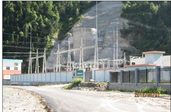
调压井及 110kV 升压站
